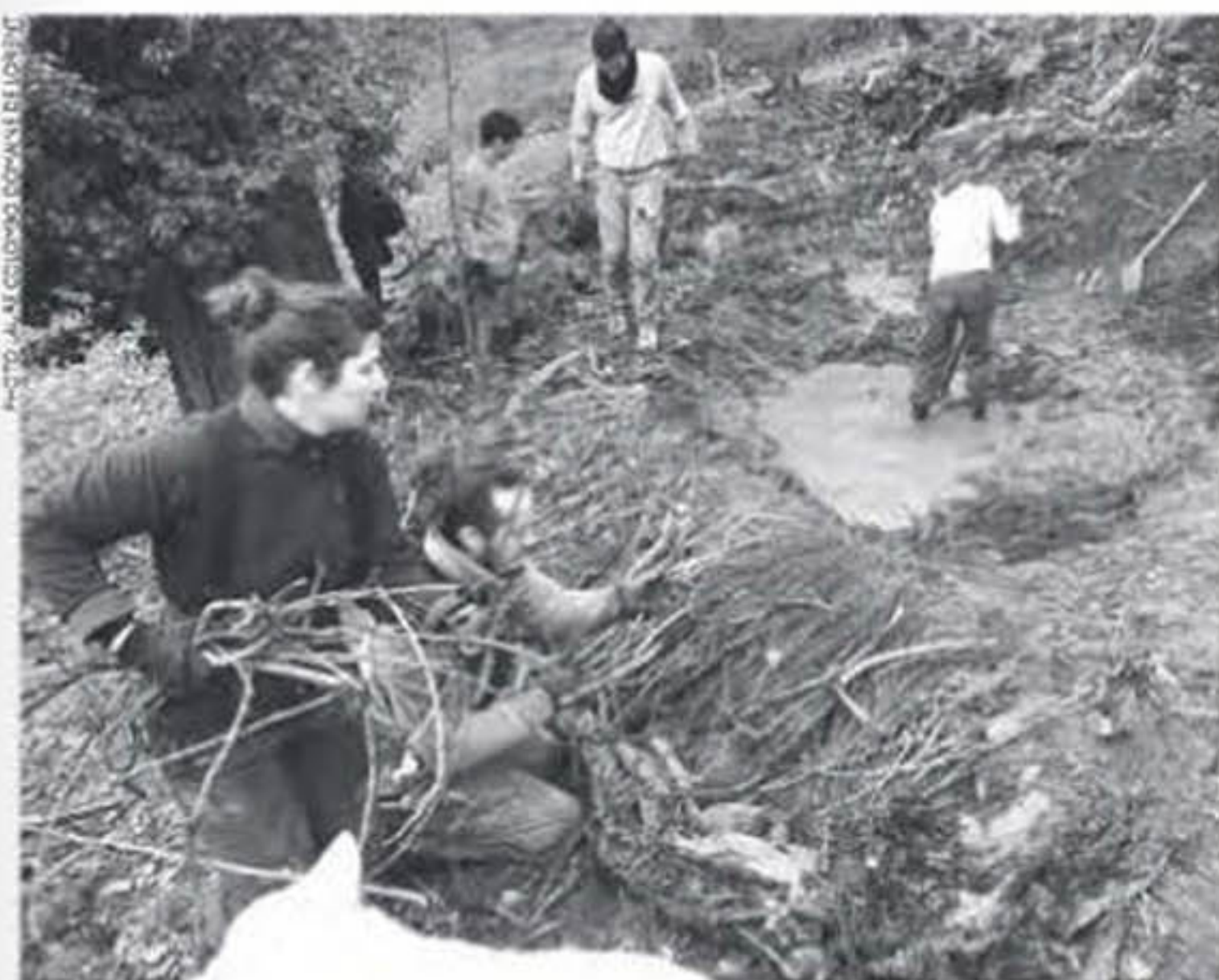
Chantier d'aménagements inspirés des techniques des castors dans une optique « low tech » (basse technologie). Talweg au domaine de Lorient.
